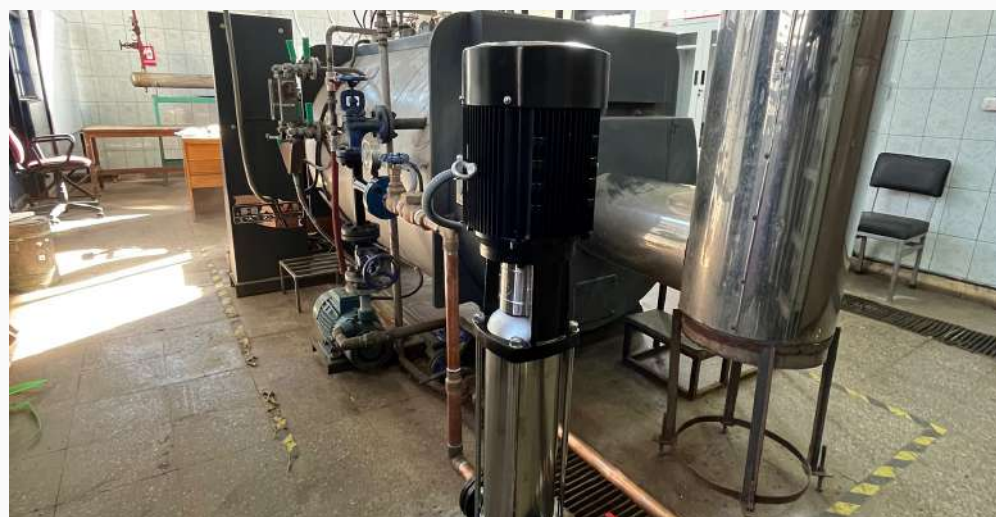
MODERNIZACIÓN DE CALDERA CON BOMBA GEMELA
